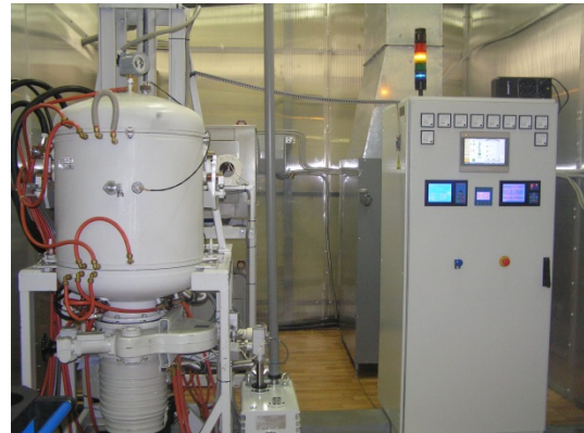
Рисунок 3 – Вид участка вакуумной термообработки с электропечью СВЭ-25/15М
